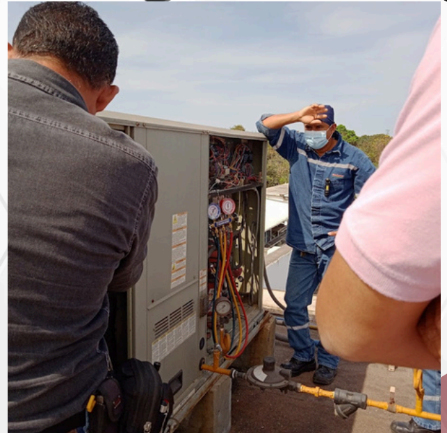
Cliente: Distribuidor CARRIER. Curso: Mantenimiento del sistema HVAC.
